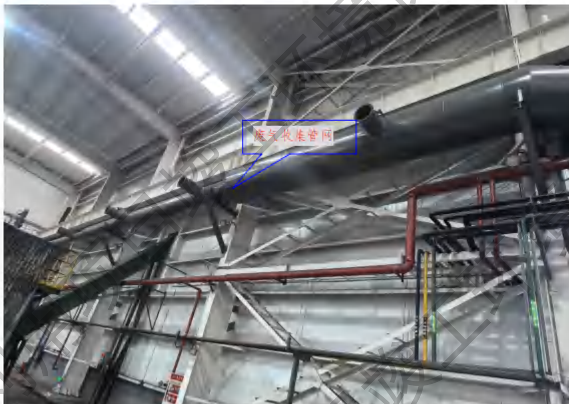
卸料大厅废气收集管网
