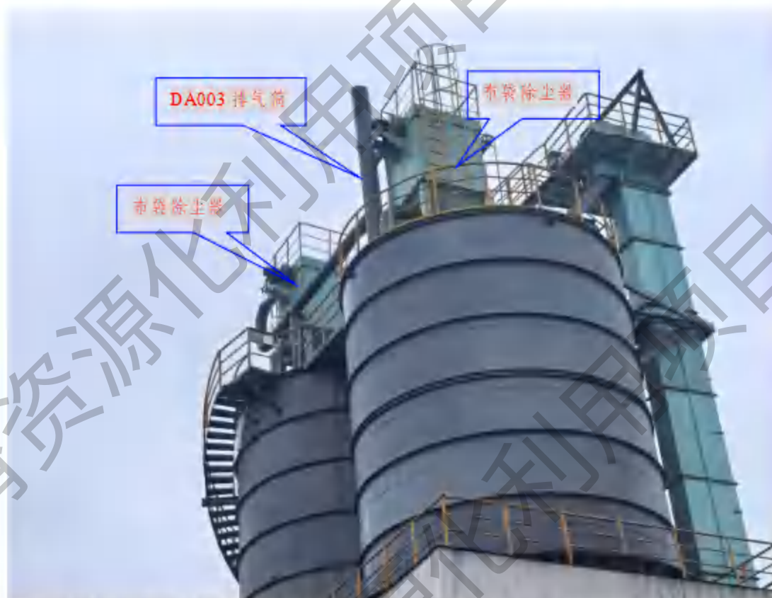
灰渣仓粉尘、打包废气处理装置（布袋除尘器+DA003 排气筒）
