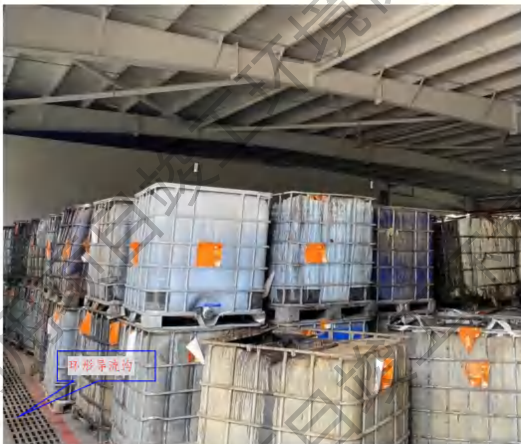
油基岩屑暂存库环形导流沟
