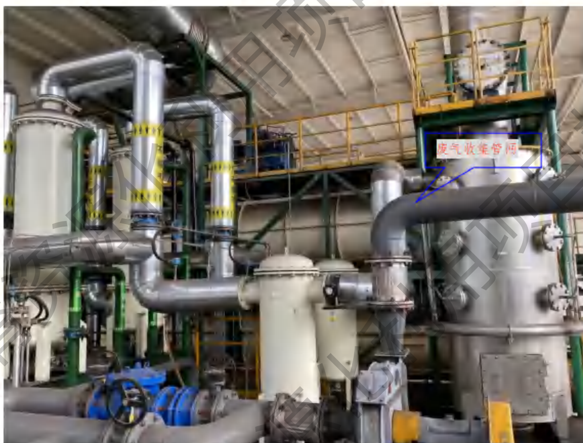
冷凝液废气收集管网
