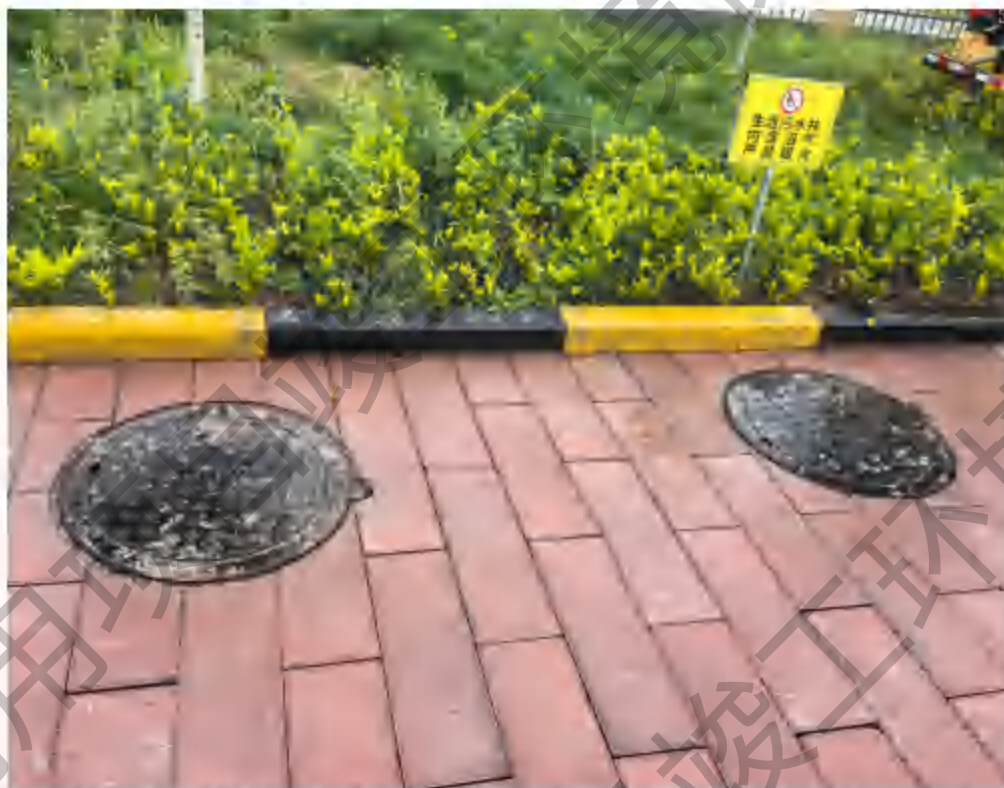
生活污水处理系统（地下，隔油池+生化池）
