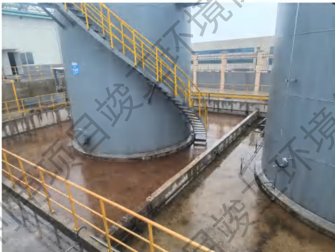
回收油储罐及围堰
